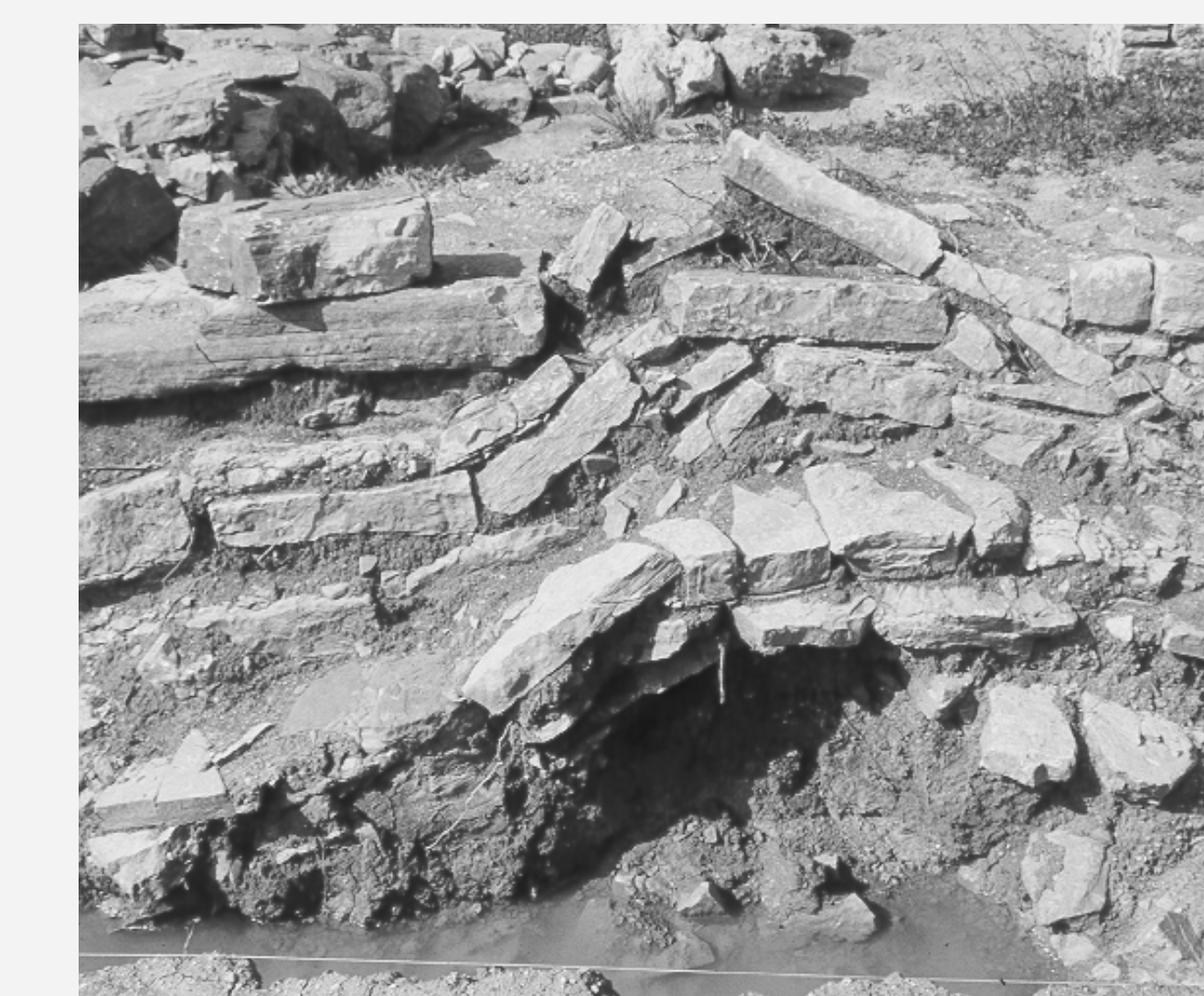
Plegamientos en muros enlosados y pavimentos
