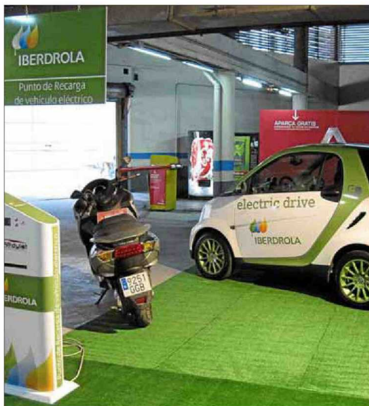
Punto de recarga eléctrico de prueba para instalarlo en Valladolid. / D.V.
