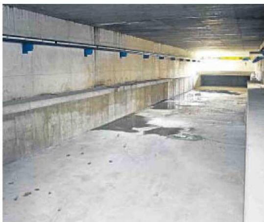
El búnker en el que se instalará el láser de petavatio.
