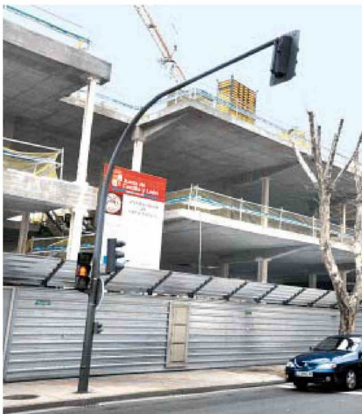
Obras del nuevo edificio de I+D+i de la Universidad en la calle Espejo. /BARROSO
