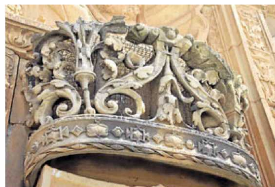
Detalle de la corona que cubre el escudo de España en el que se aprecia el deterioro que sufren los elementos que están hacia afuera. / Fotos: BARROSO
