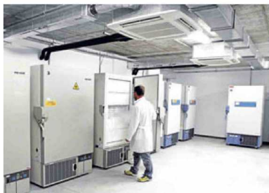
Ya están funcionando algunos equipos para el mantenimiento de materiales.
