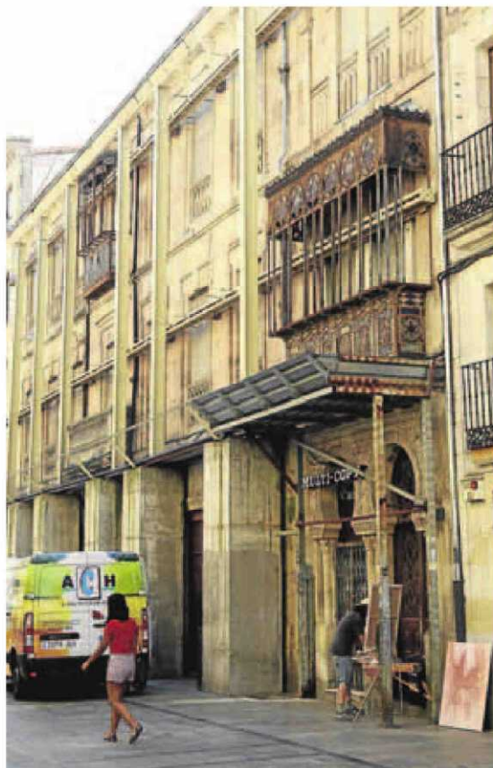
El antiguo hotel Universal sigue apuntalado y abandonado. :: ALMEIDA
