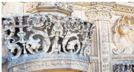
Los relieves de la fachada cubiertos de excrementos. | ARCHIVO
