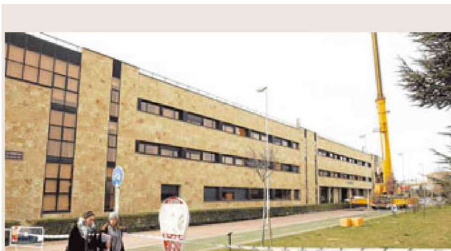
Instalación del equipo de climatización en Derecho La Universidad ha iniciado los trabajos para dotar de un nuevo equipo de climatización a la Facultad de Derecho. Una gran grúa utilizada para la instalación de los equipos provocó ayer el corte de parte de los accesos al centro universitario. | ALMEIDA
