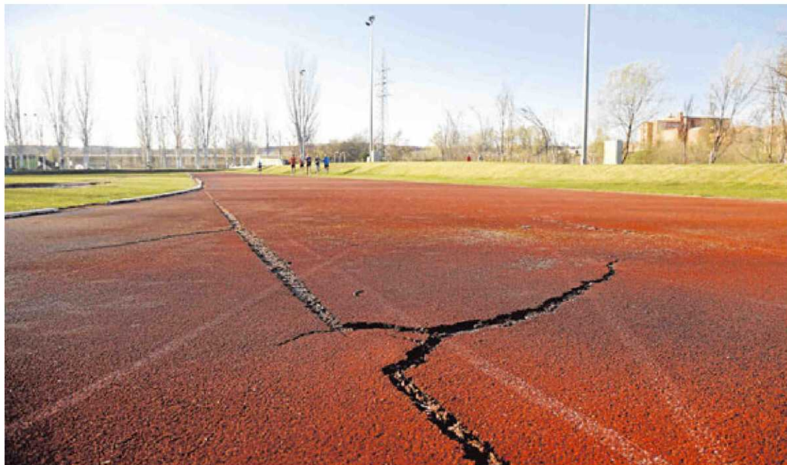
Fotografía que refleja el mal estado en el que se encuentra el pavimento de la pista de atletismo de Salas Bajas. | FOTOS: ALMEIDA
