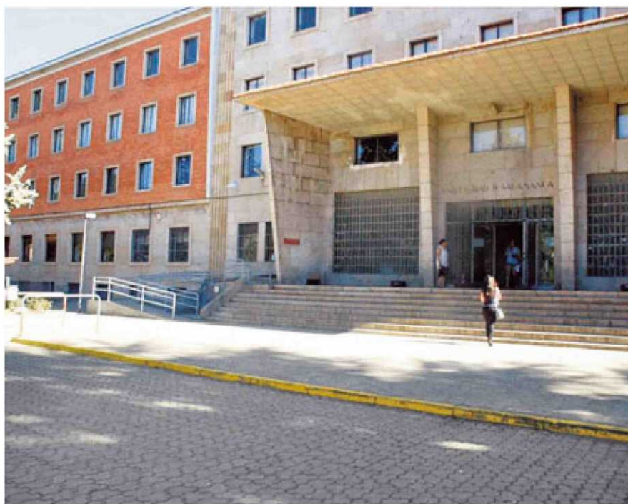
Las obras incluyen la renovación de la rampa de acceso al edificio de Psicología y Bellas Artes.
