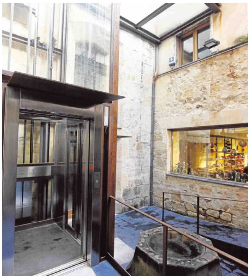
Ascensor instalado en un patio exterior de las Escuelas Mayores. | FOTOS: ALMEIDA
