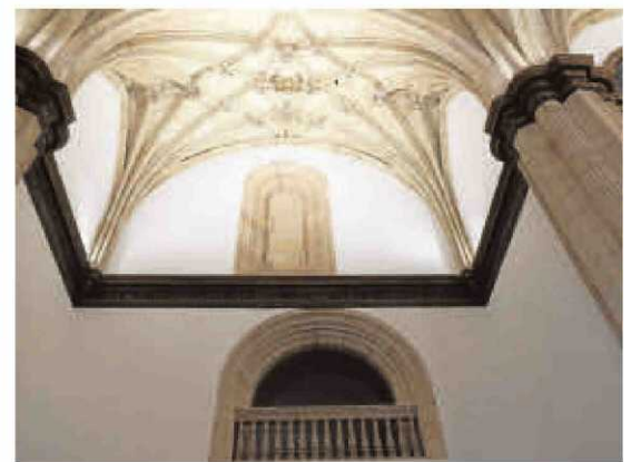
Explosión de luz en todos los elementos arquitectónicos.
