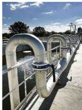
Instalaciones de la depuradora. / A.R.
