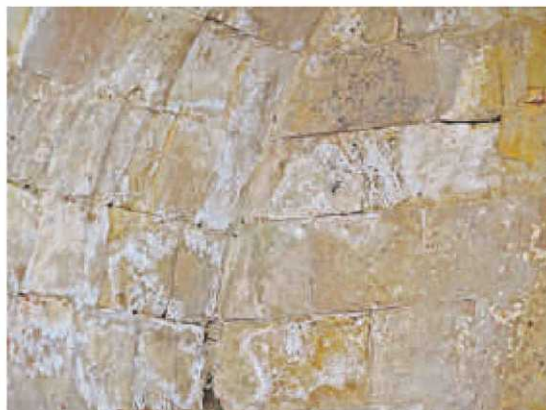
Manchas blancas, eflorescencias salinas, en los muros de la cripta.
