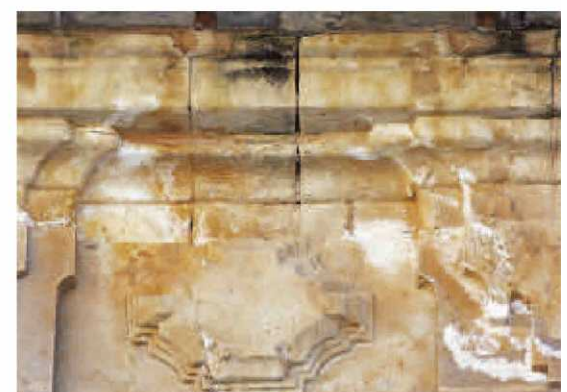
Las manchas han reaparecido tres años después de su eliminación.
