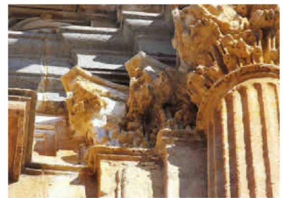
Abundante acumulación de sales en uno de los capiteles del monumento.
