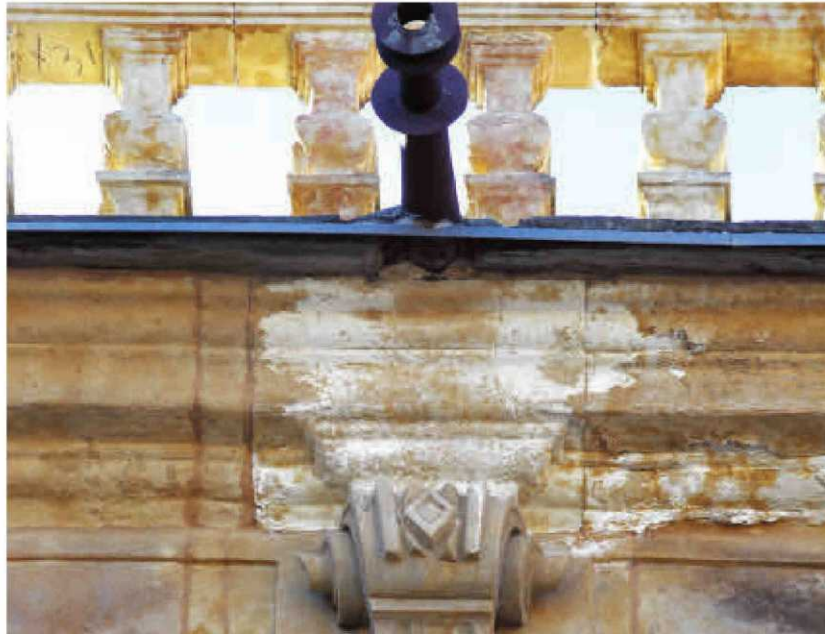
Eflorescencias salinas aparecidas bajo un canalón en una de las cornisas de la Plaza. | REPORTAJE GRÁFICO: ALMEIDA
