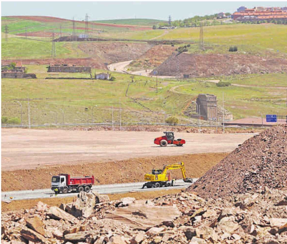
Obras de urbanización del futuro sector industrial de Peña Alta, en el que se construirá el futuro Puerto Seco. | MANUEL LAYA
