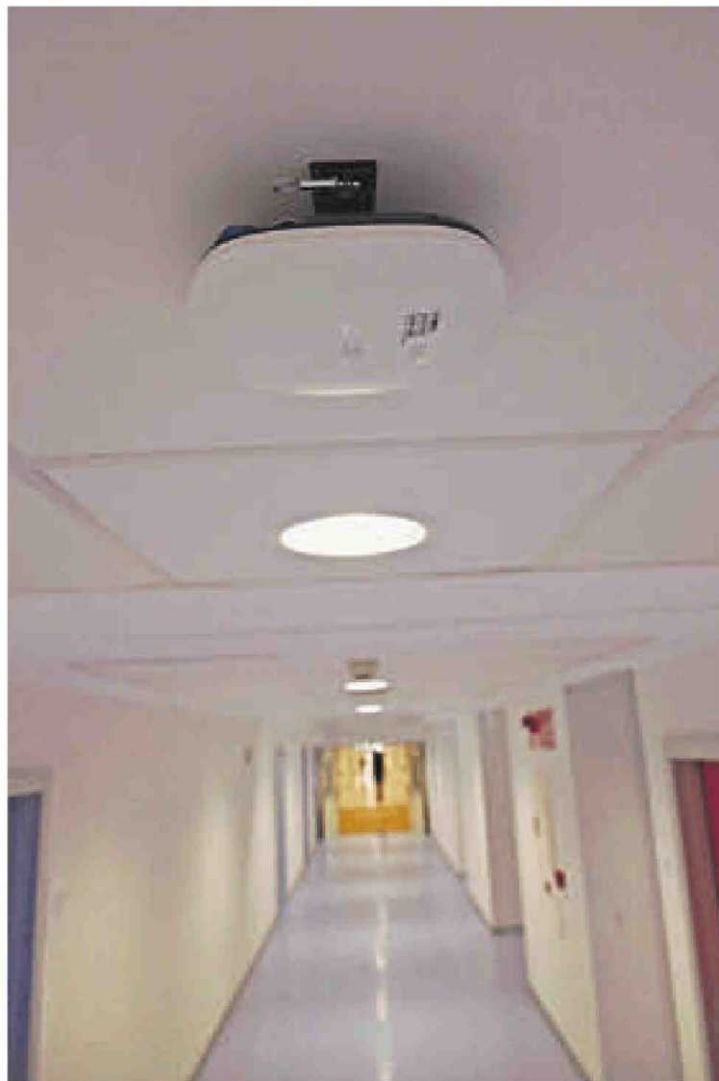
Más de 670 repetidores wifi en los techos del Hospital. | ALMEIDA
